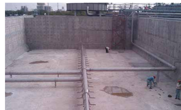
Высокоэффективная система подачи воздуха в аэротенк.
