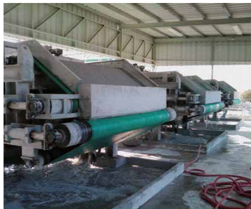
Обезвоживание шлама на ленточном фильтр-прессе
